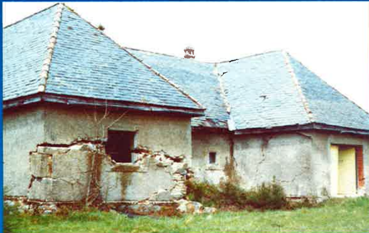
GRIETAS EN CASA ABANDONADA
