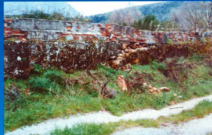
GRIETAS EN MURO
